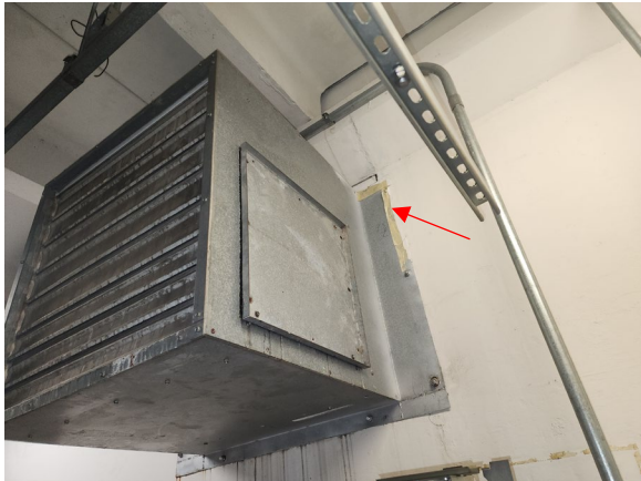
HA 4: HVAC Tape
